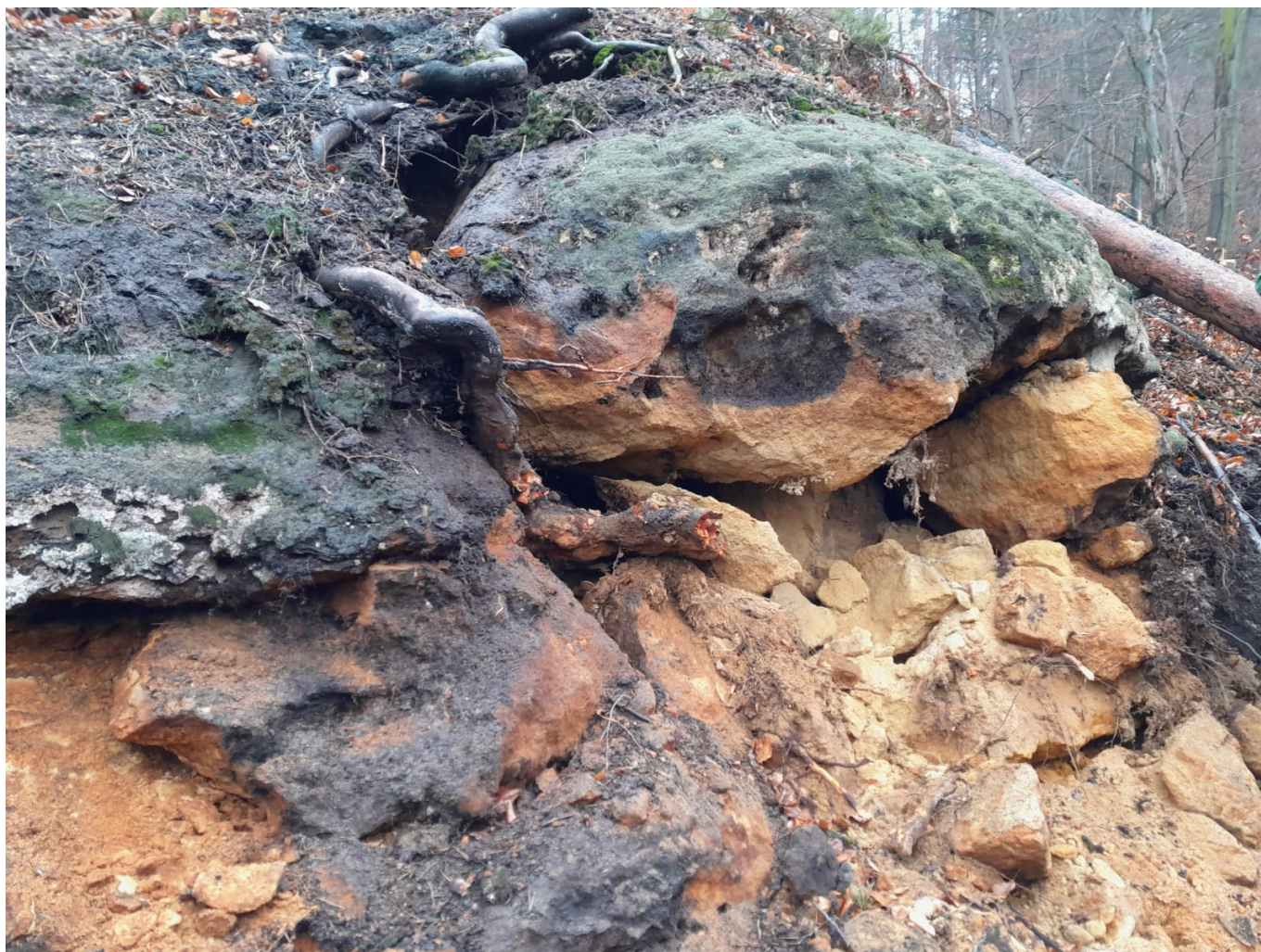
NebezpeĀnĀ½ skalnĀ blok nad cestou k PravĀickĀ© brĀjnĀ. Foto: Stanislav Feigl
