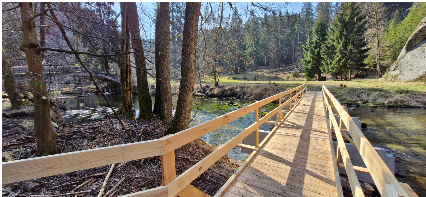
Náivã;tãvnãkã`m je po dobu opravy mostku k dispozici provizornã lãivka pães Kamenici. Foto: TomãĀĀ Salov
