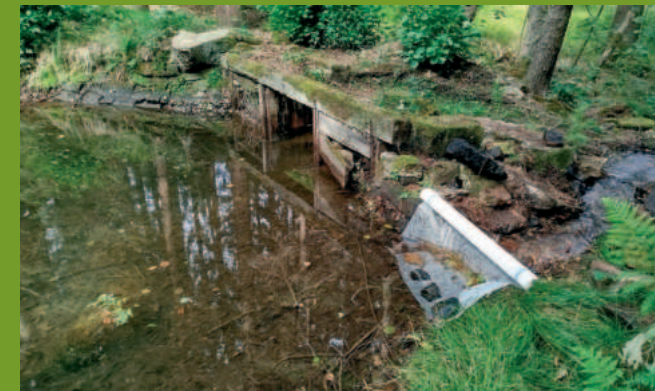
Stav hráze rybníčku před rekonstrukcí. © J. Semík
